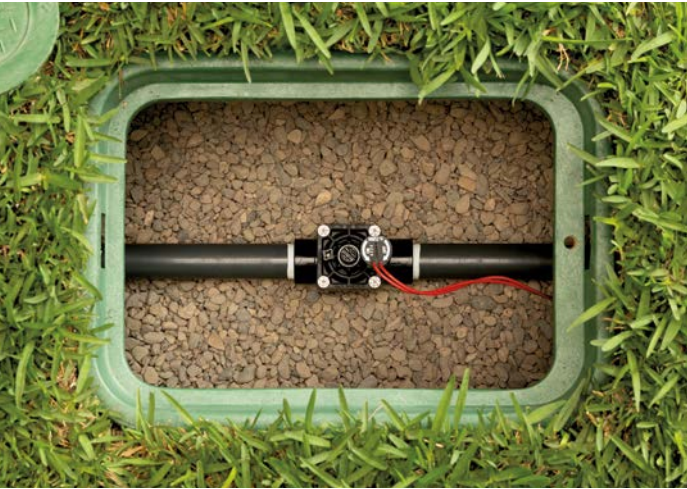
Électrovanne PGV-100G installée
