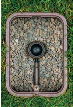
Valvola di spurgo automatico installata
