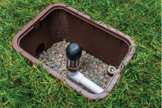
Valvola di sfiato aria/vuoto installata
